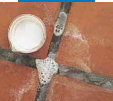
Curățarea petelor de eflorescențe
