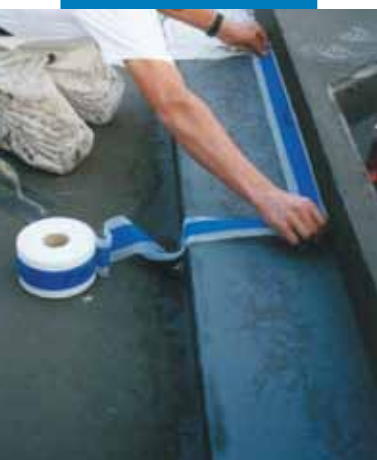
Un exemplu de impermeabilizare elastică cu Mapeband a unui unghi situat între radier și perete
